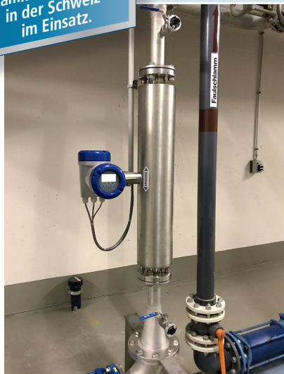
Einsatz Schlamm entwässerung ARA
